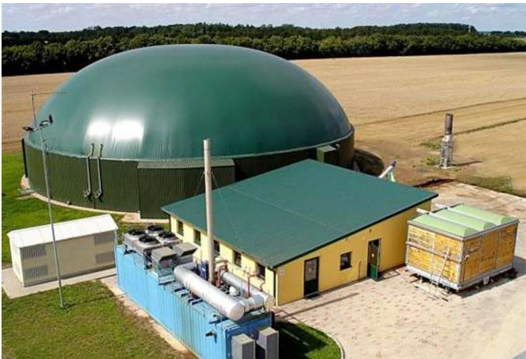
Рис.3.12. Загальний вигляд біогазової установки на Київському полігоні №5
