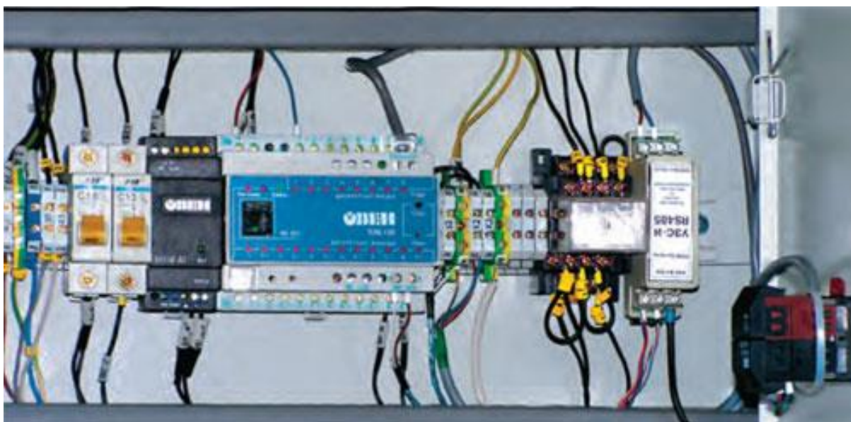
Рисунок 1.2 – Загальний вигляд шафи керування з контролером ПЛК-100
