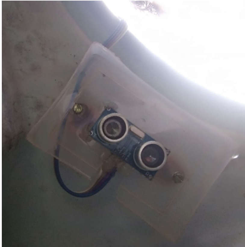
Рисунок 3.15 – Розміщення ультразвукового датчика у резервуарі
