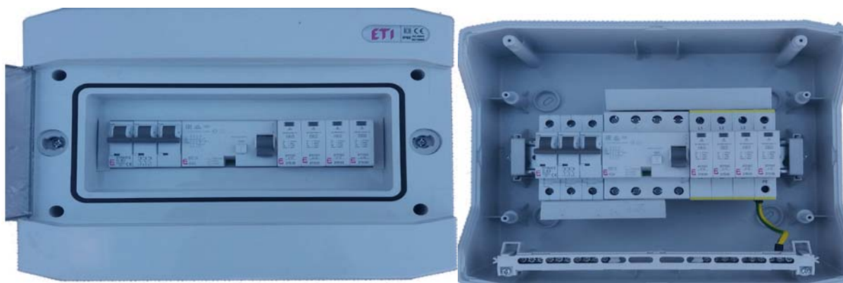
Рисунок 2.13- Щит захисту інвертора по АС
