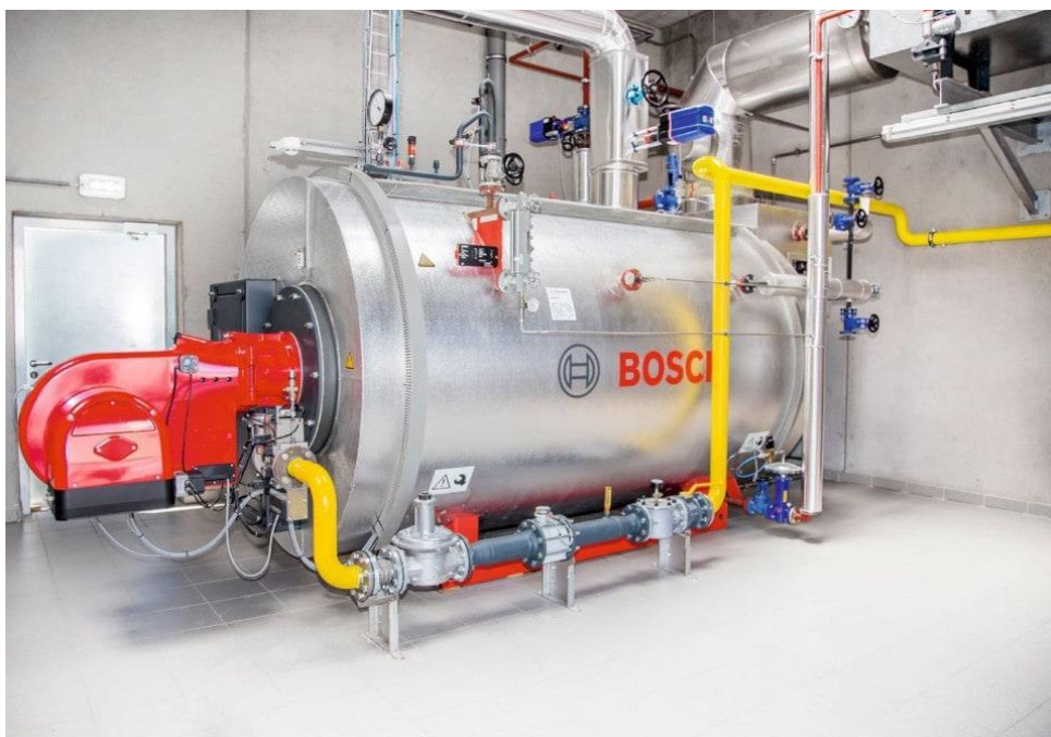
Рисунок 1.4 - Теплогенераційне обладнання АСО
