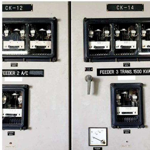
Панель електромеханічного реле
