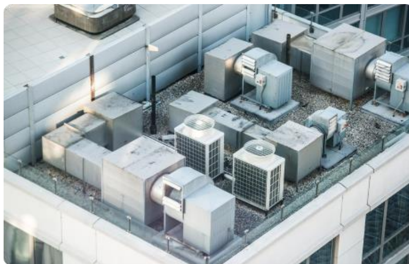
Рисунок 1.1 – Загальний вигляд і компоновка системи центрального кондиціонування
