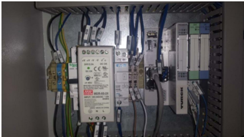
Рисунок 2.6 - Шафа керування станції регулювання тиску
