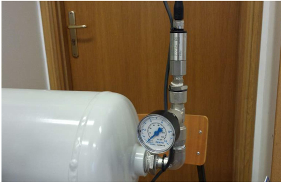
Рисунок 2.3 - Датчик тиску TURCK, встановлений на об'єкті.
