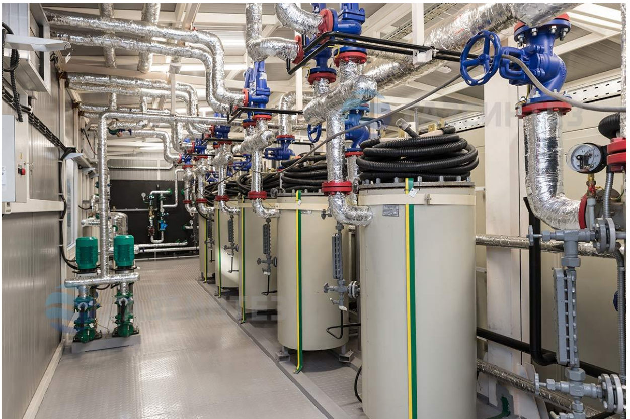
Рисунок 1.2. – Загальний вигляд електрокотельні, з її системою кабелів, трубопроводів та обладнання.
