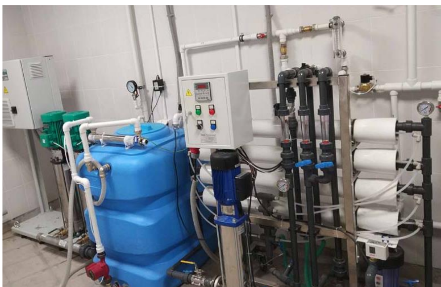
Рисунок 1.1 – Загальний вигляд промислової установки для очистки води
