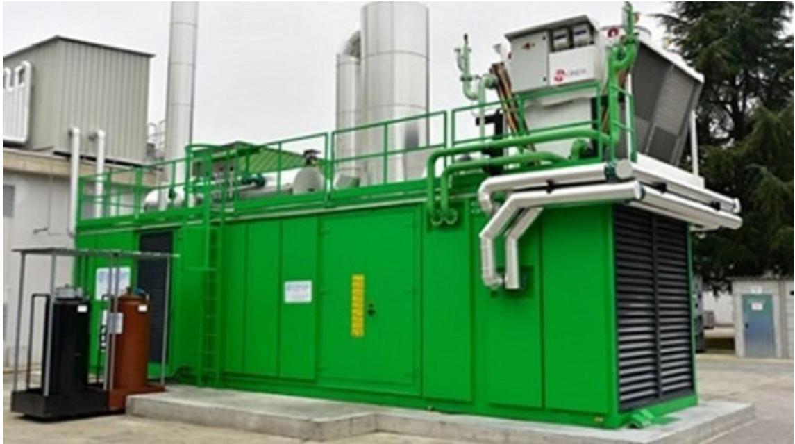
Рисунок 1.2 – Зовнішній вигляд когенераційної установки
