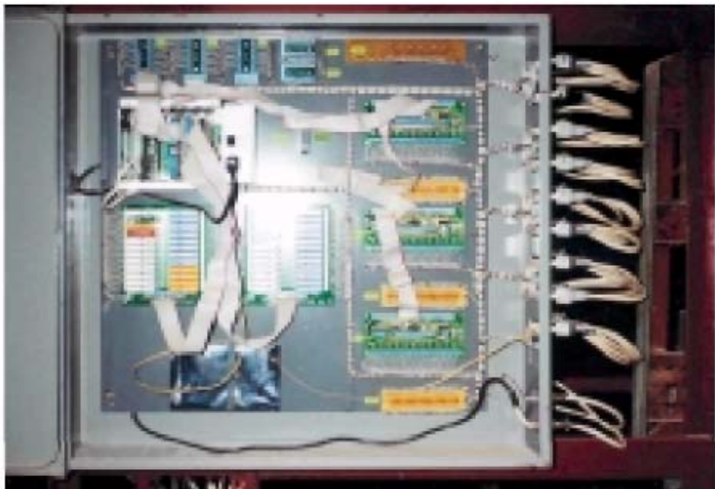
Рисунок 2.2 – Загальний вигляд щита контролера
