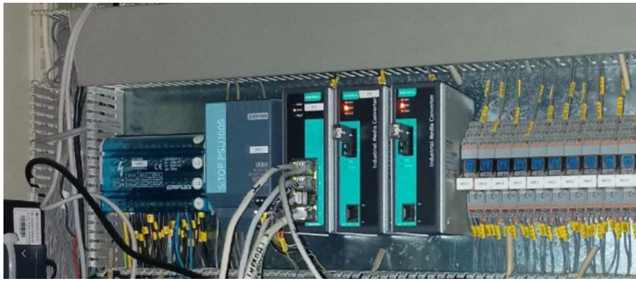
Рисунок 1.9 – Мережеве обладнання на DIN рейці. Збарзький цукровий завод
