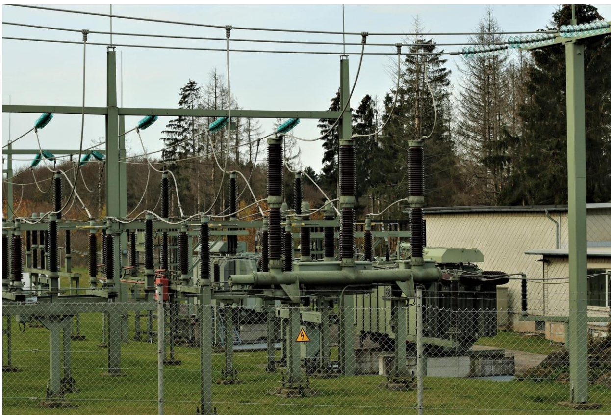
Рисунок 1.1– Приклад вигляду трансформаторної підстанції [2]
